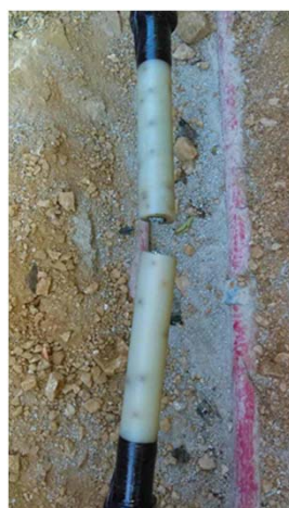
Slika 3 „nezdravo“ stanje izolacije kabela
