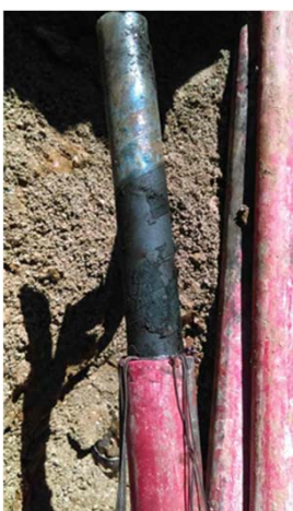
Slika 2 „nezdravo“ stanje zaslona izolacije kabela (grafit + vodljiva traka)
